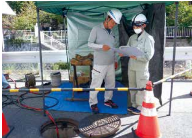
鈴木さん(右)の現場業務の光景 「下水道改築更新工事 現場監督」
